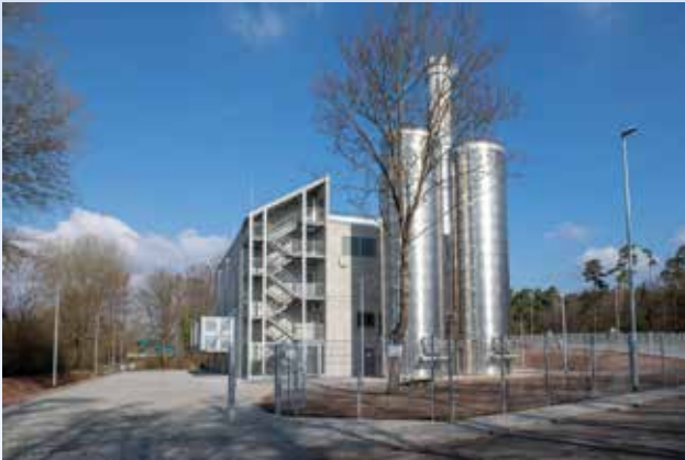
Das Blockheizkraftwerk in Ramstein-Miesenbach
